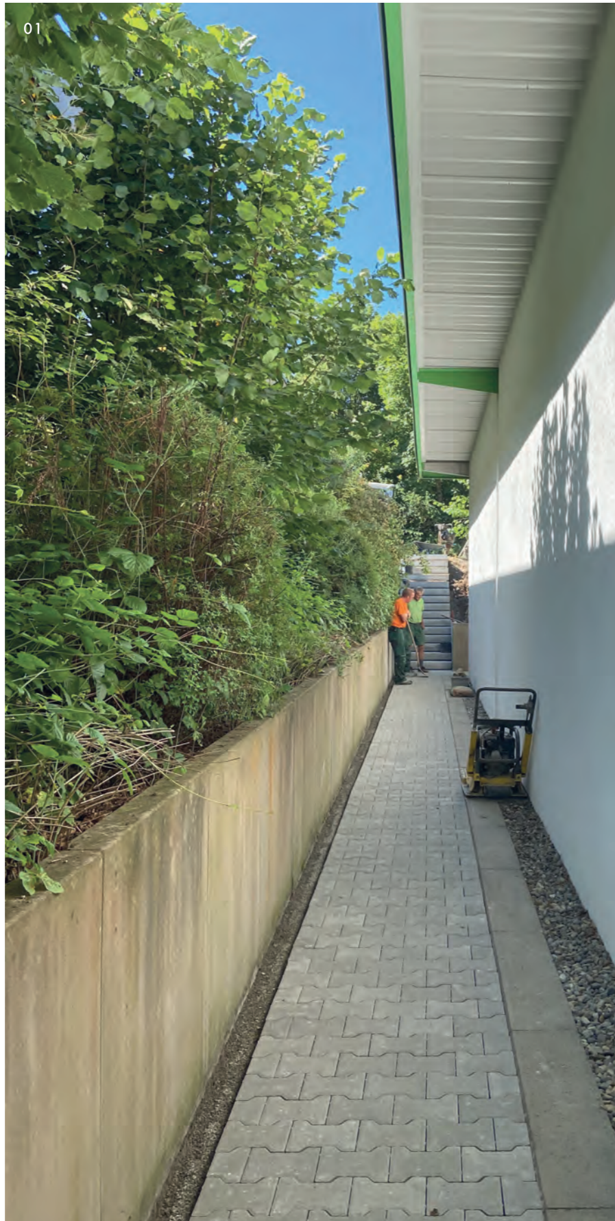
01 Rettungswege: Aus dem Bereich des Innenhofes müssen befestigte Wege und eine Treppe zur Erreichbarkeit der öffentlichen Fläche hergestellt werden.
