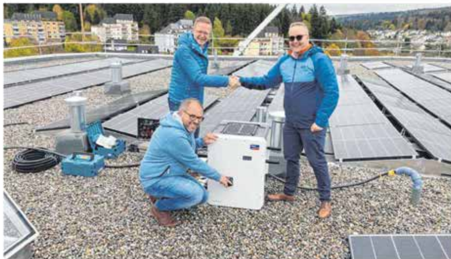
Strom an: Symbolisch dreht Tuttlingens Baudezernent Florian Steinbrenner (knieend) den Schalter für die PV-Anlage um. Michael Heim von der Wohnbau (links) und Kevin Haus von den Stadtwerken freuen sich, dass die Mieter bald mit günstiger Solarenergie versorgt werden können.
